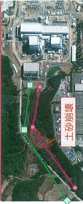
法面の土砂崩壊
