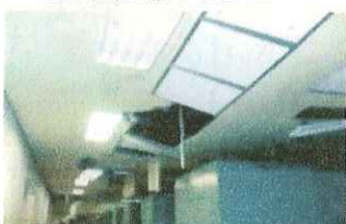
天井化粧板の脱落
