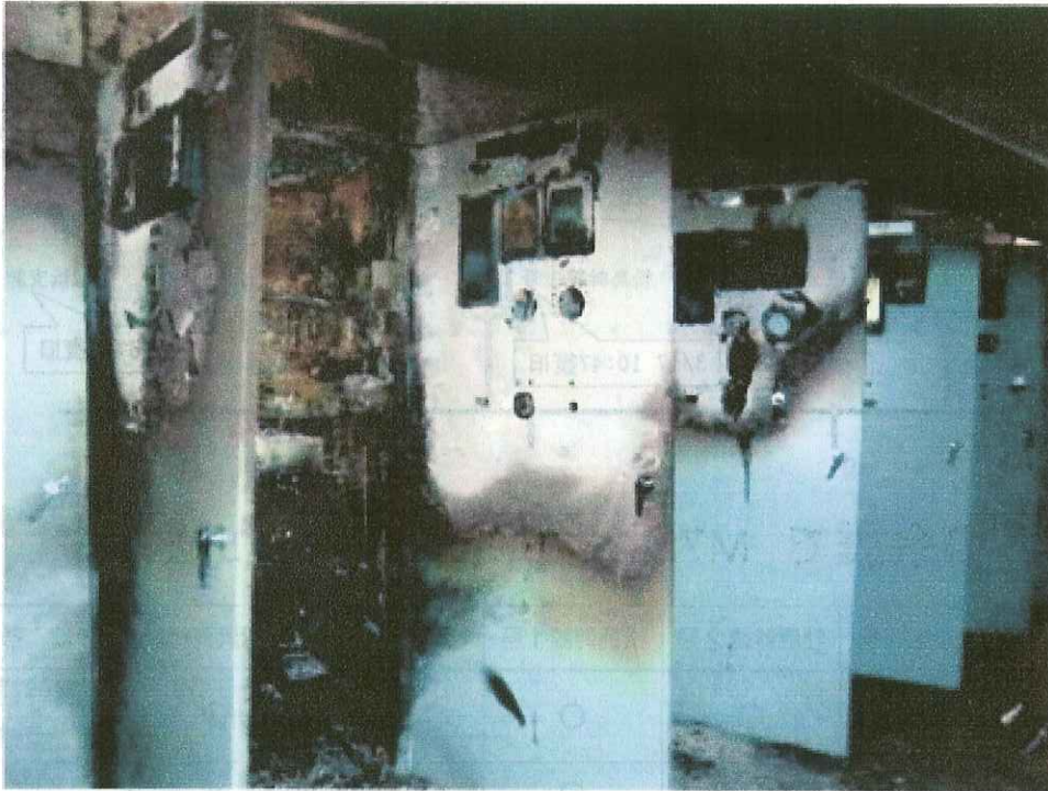
高圧電源盤 現場写真
