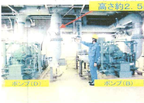
原子炉補機冷却水B系ポンプ室
